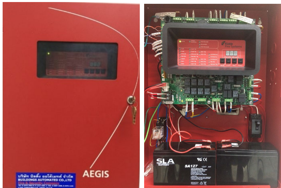
ภาพที่ 3.11 เครื่องควบคุมระบบดับเพลิง
