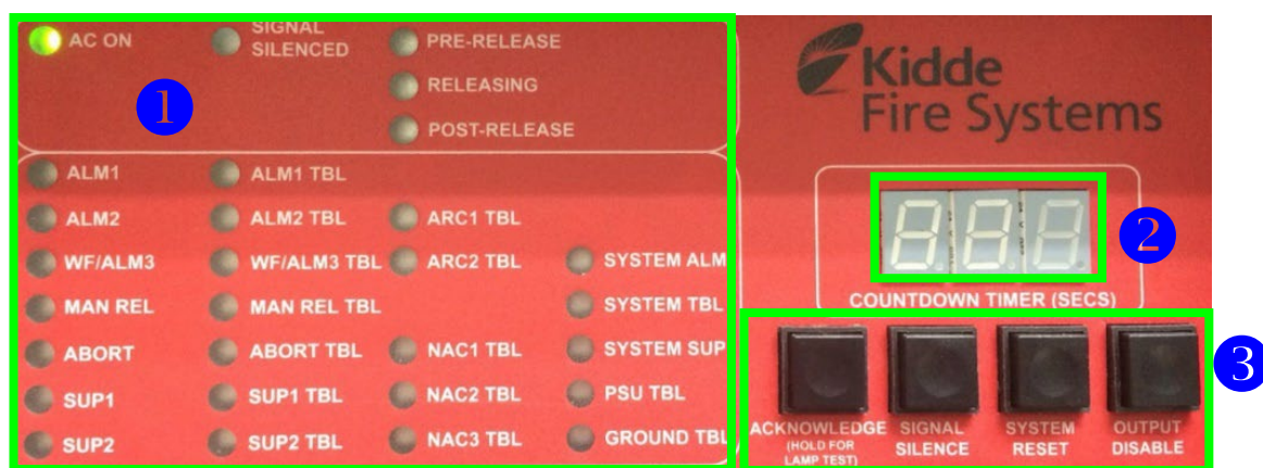
ภาพที่ 3.12 แผงควบคุมระบบแจ้งเหตุเพลิงไหม้
